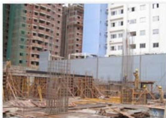
Fotos do Canteiro de Obras estrutura do andar térreo e pilares do pilotis
