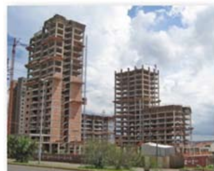
Fotos do Canteiro de Obras blocos A e C com a 1ª fase da estrutura chegando ao fim
